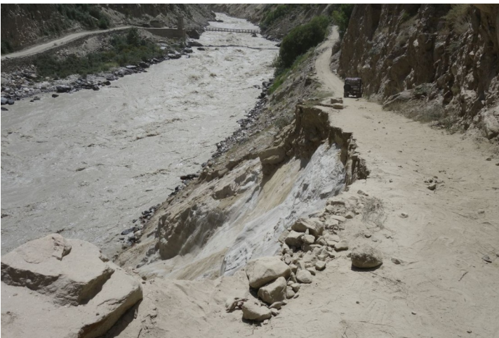
Die Straße in das obere Braldotal brach an mehreren Stellen weg
